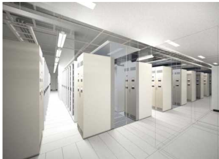
データセンター内部
